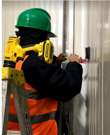
Figura 3. 21 Montaje de sensores
