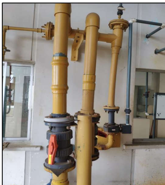
Figura 2.15 Válvulas y tuberías sin etiquetar
