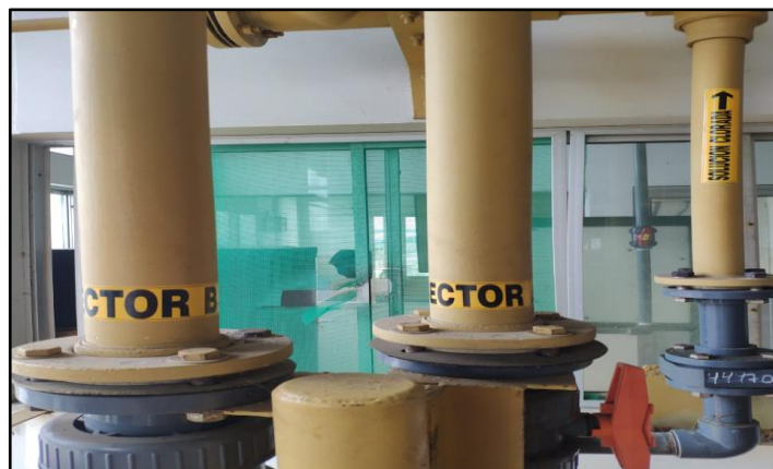
Figura 2.25 Tuberías y válvulas etiquetadas
