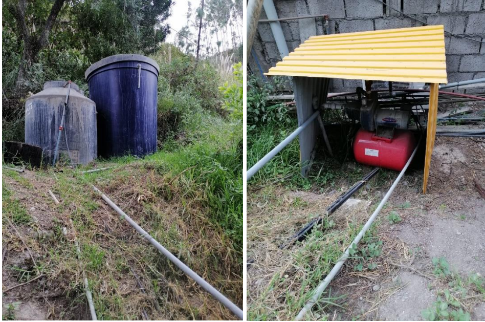
Figura 3.5 Implementación de un sistema pulmón de agua para el laboratorio de control de calidad
