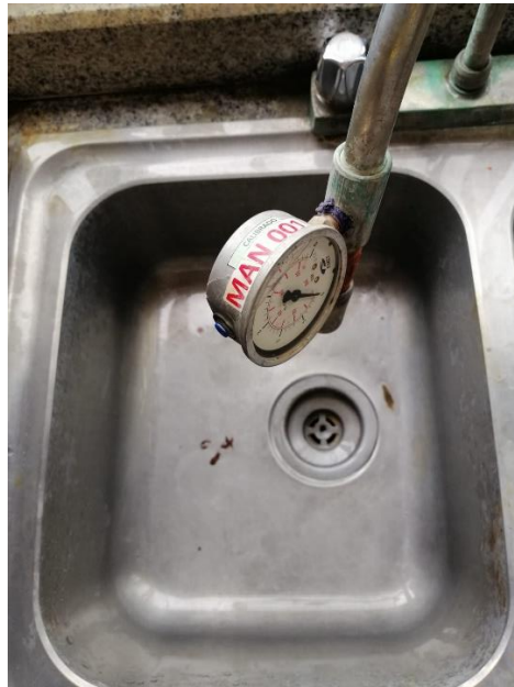
Figura 3.6 Implementación de un manómetro calibrado y certificado para el control de presión del agua
