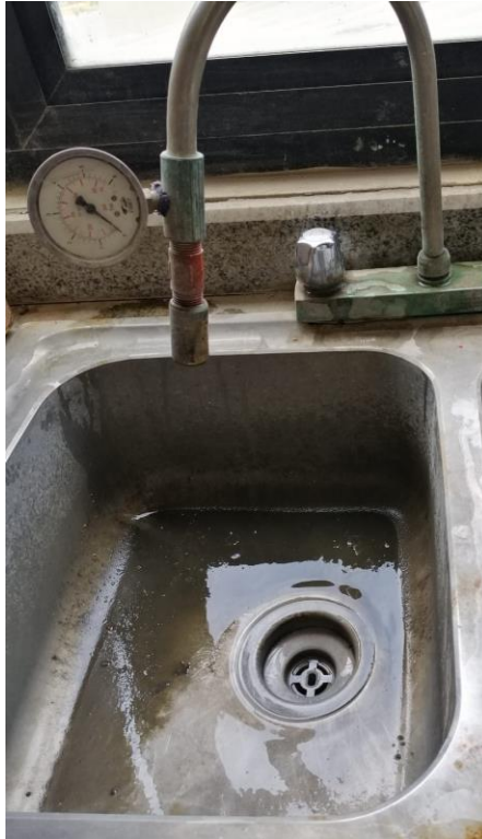
Figura 2.23 Manómetro sin calibración
