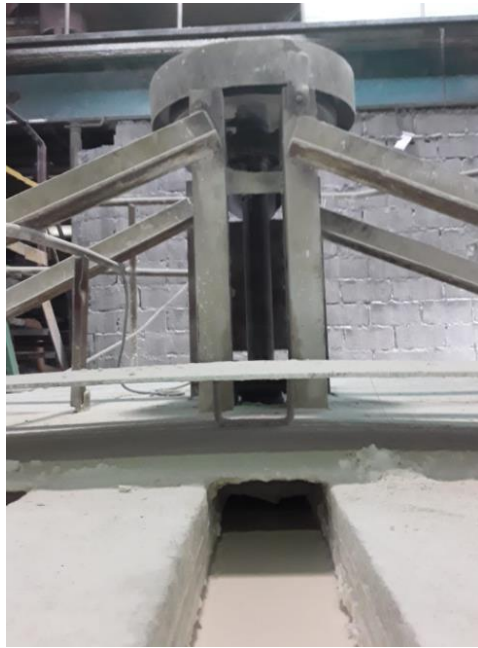
Figura 2.21: Sistema de agitación de tanques de lechada de cal Fuente: Autoría propia
