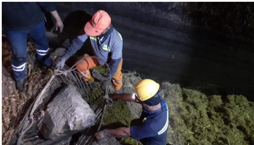
Figura 2.5: Piedras atoradas entre los conductores del tren de molinos Fuente: Autoría propia
