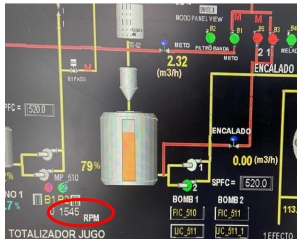
Figura 2.8: RPM que indican que la bomba trabaja al 70%
