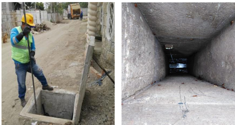
FIGURA 3.4. Sistema de mantenimiento de alcantarillado (Fuente: Aguapen-EP)
