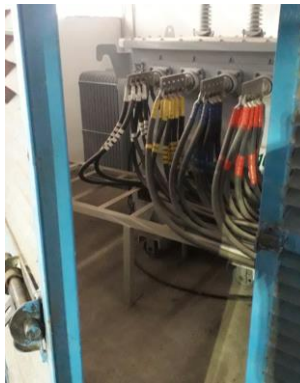
FIGURA 4.1 CUARTO DE TRANSFORMADOR ABIERTO
