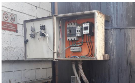
FIGURA 4.2 TABLERO ELÉCTRICO DE CONTROL ABIERTO
