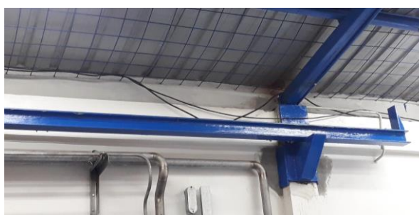
FIGURA 4.4 CABLES ELÉCTRICOS EXPUESTOS
