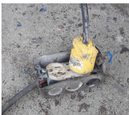
FIGURA 4.5 EXTENSIÓN ELÉCTRICA EN MAL ESTADO
