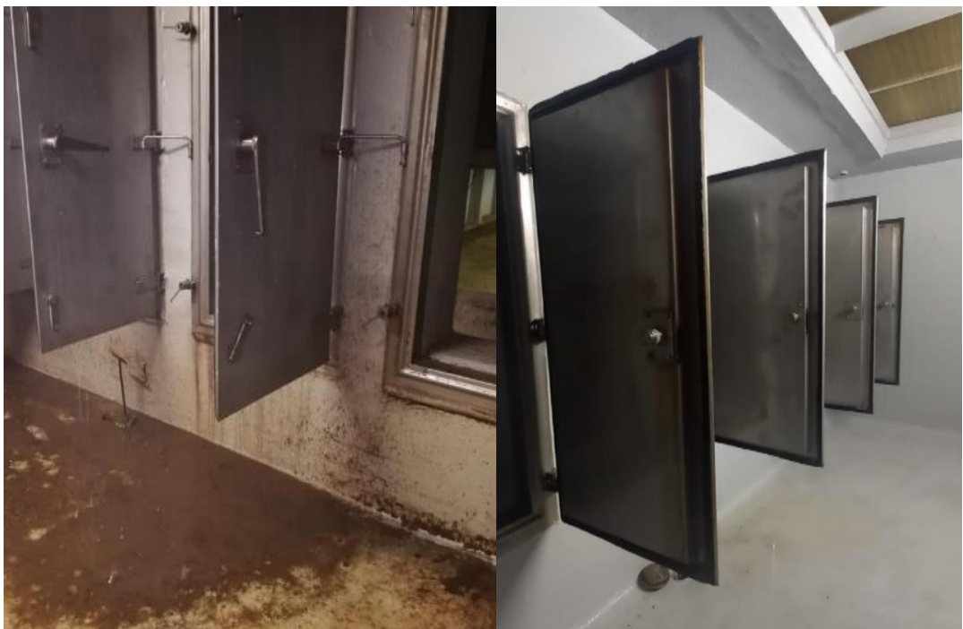
Figura 4.2 Antes y después del cambio de sellos de las compuertas de los saladines
