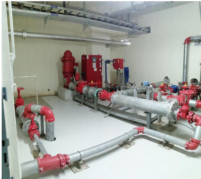
Figura 4.15 Cuarto de Bombas del Sistema Contra Incendios
