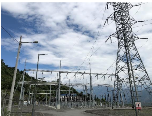
Figura 1.4 Subestación San Francisco
