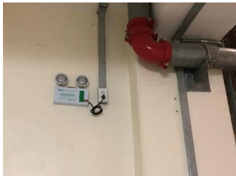
Figura 1.12 Iluminación de emergencia
