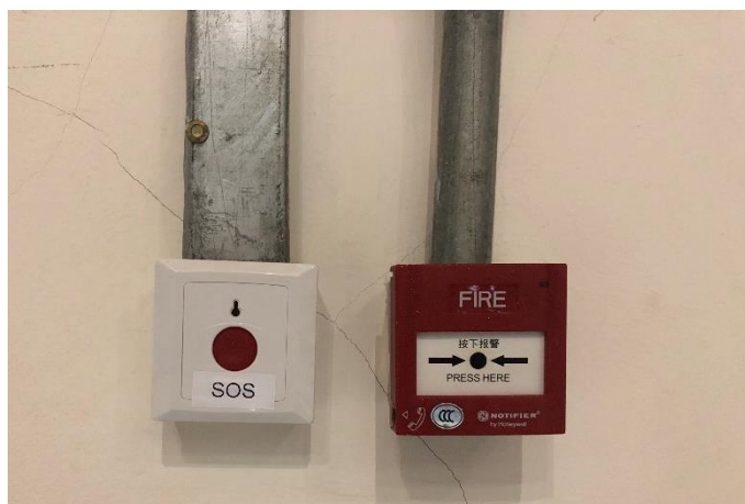
Figura 1.6 Botonera de accionamiento manual para incendio y emergencia
