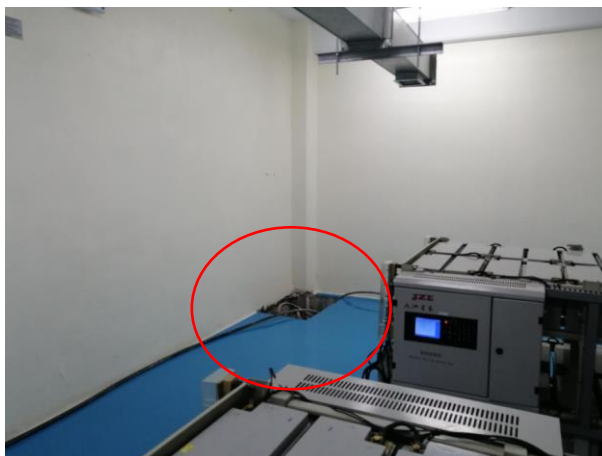
Figura 4.29 Paso de cables a sala de baterías sin protección corta fuegos
