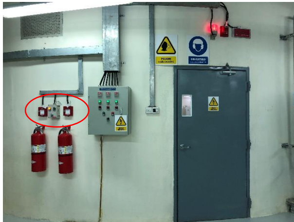
Figura 1.10. Botoneras de accionamiento local de descarga CO 2
