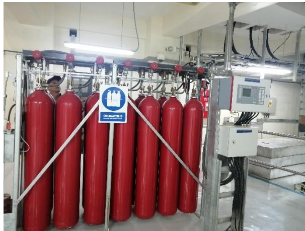
Figura 1.9. Conjunto de banco de cilindros de CO 2
