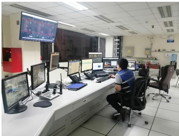
Figura 2.1. Sala de control de casa de máquinas
