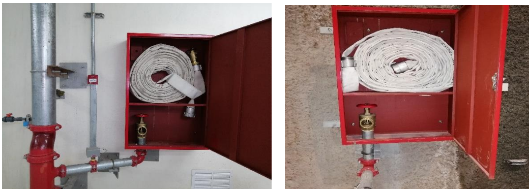
Figura 4.18 Disposición de dos Bocas Equipadas de Incendio
