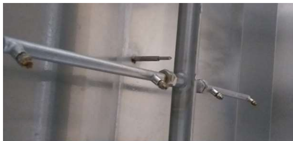
Figura 3.38 Boquillas de aspersión con presencia de suciedad (Fuente: Planta de Proceso Empresa Durán)
