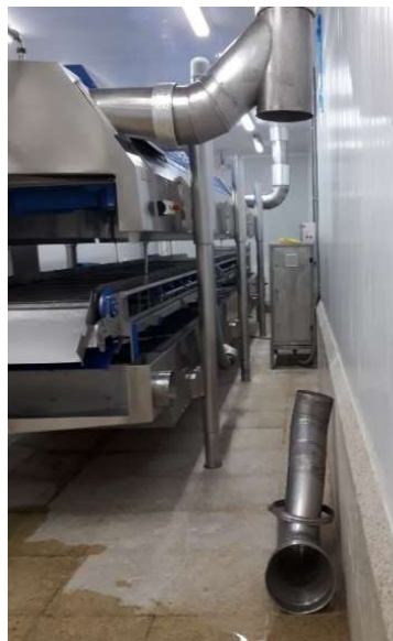
Figura 3.14 Hallazgo alrededor de túnel Durán 1
