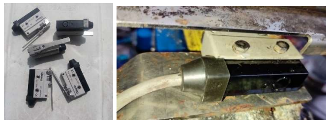
Figura 3.48 Reemplazo de todos los sensores de presencia
