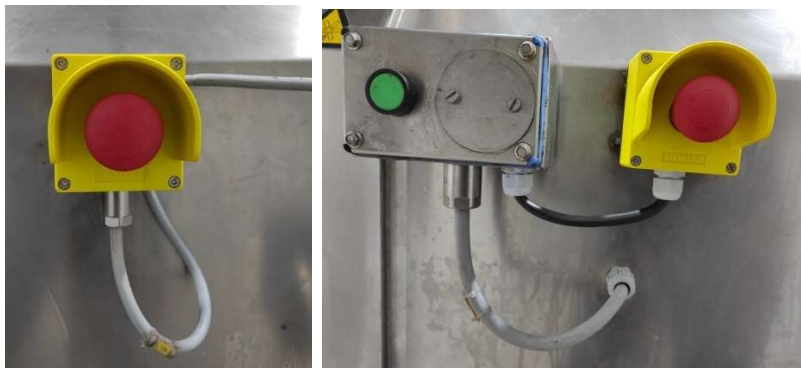
Figura 3.45 Reemplazo de todas las paradas de emergencia
