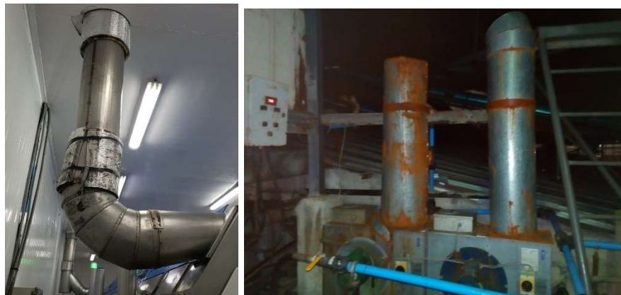
Figura 3.43 Daño en tuberías de extracción
