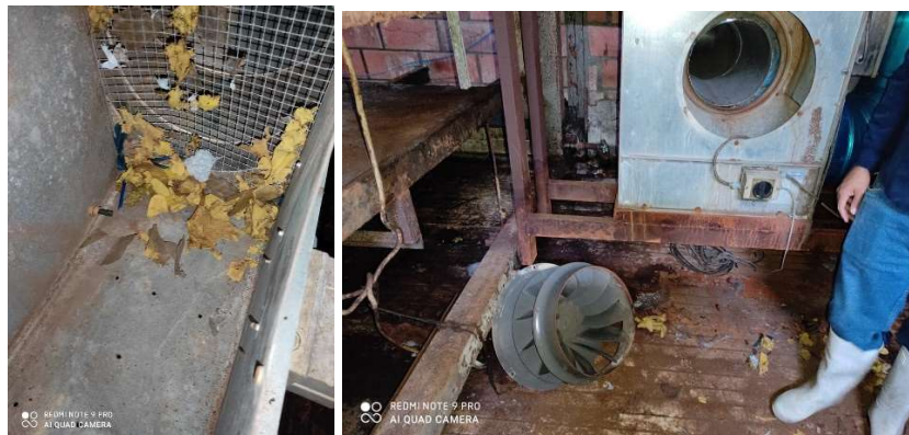
Figura 3.35 Extractores con residuos físicos en turbinas (Fuente: Planta de Proceso Empresa Durán)
