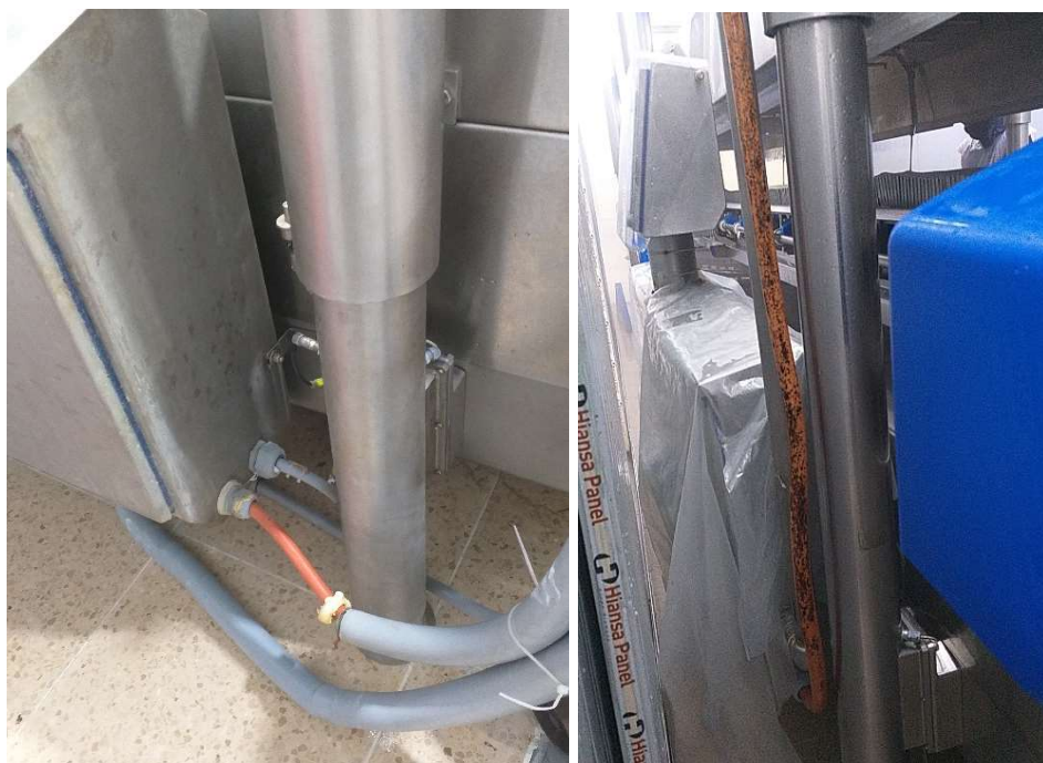
Figura 3.34 Cables de alimentación principal en mal estado (Fuente: Planta de Proceso Empresa Durán)
