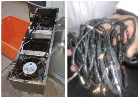
Figura 3.25 Retiro de enfriador del tablero del túnel Durán 1 (Fuente: Planta de Proceso Empresa Durán)
