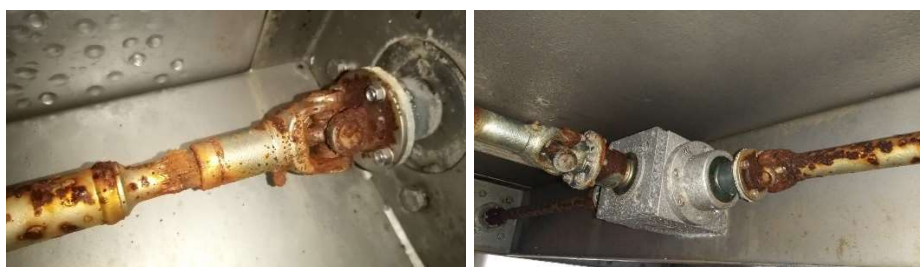
Figura 3.42 Suciedad en cardanes de elevación de túnel
