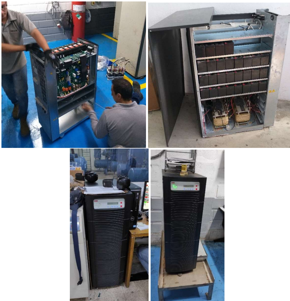
Figura 3.72 Instalación de UPS rectificador para túneles Criogenia
