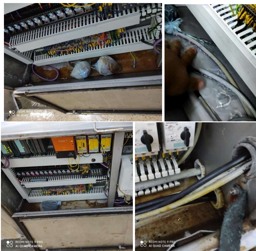
Figura 3.30 Suciedad por fuga de agua dentro de paneles control (Fuente: Planta de Proceso Empresa Durán)
