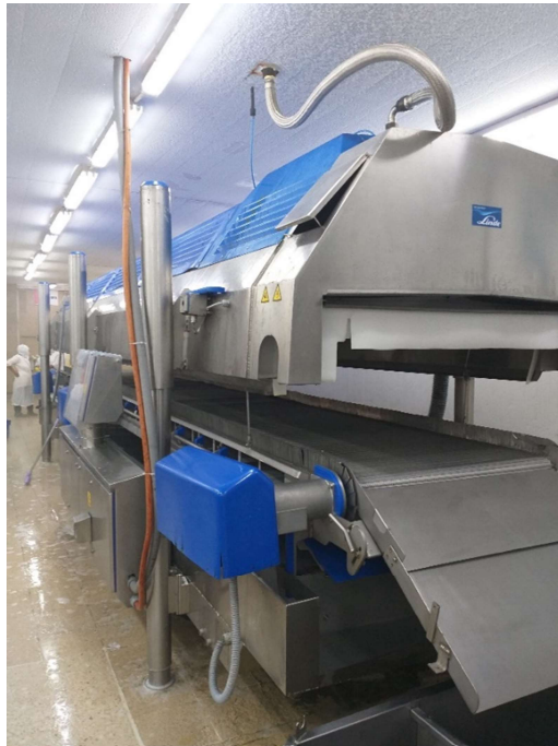
Figura 2.10 Vista lateral de túnel Durán 2 (Fuente: Planta de Proceso Empresa Durán)
