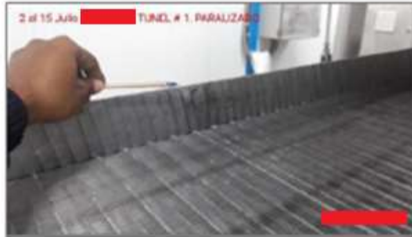
Aletas dobladas en ambos túnel.
