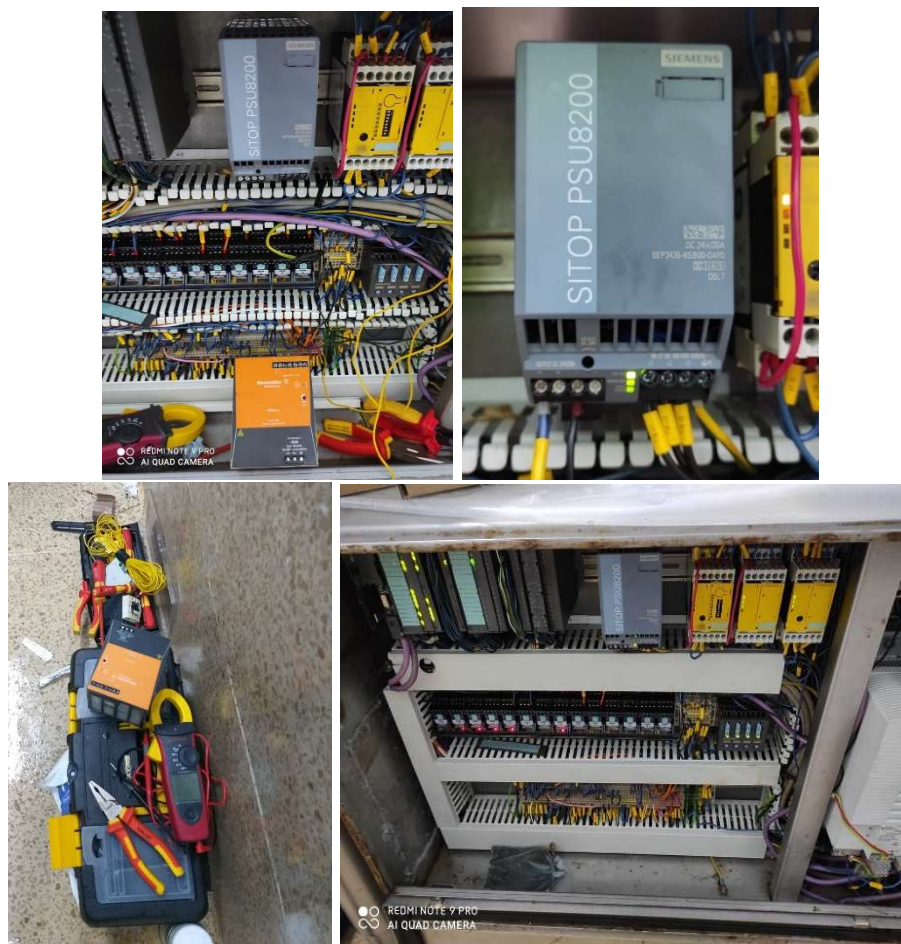
Figura 3.73 Vuelta a estado inicial 24VDC túnel Durán 1
