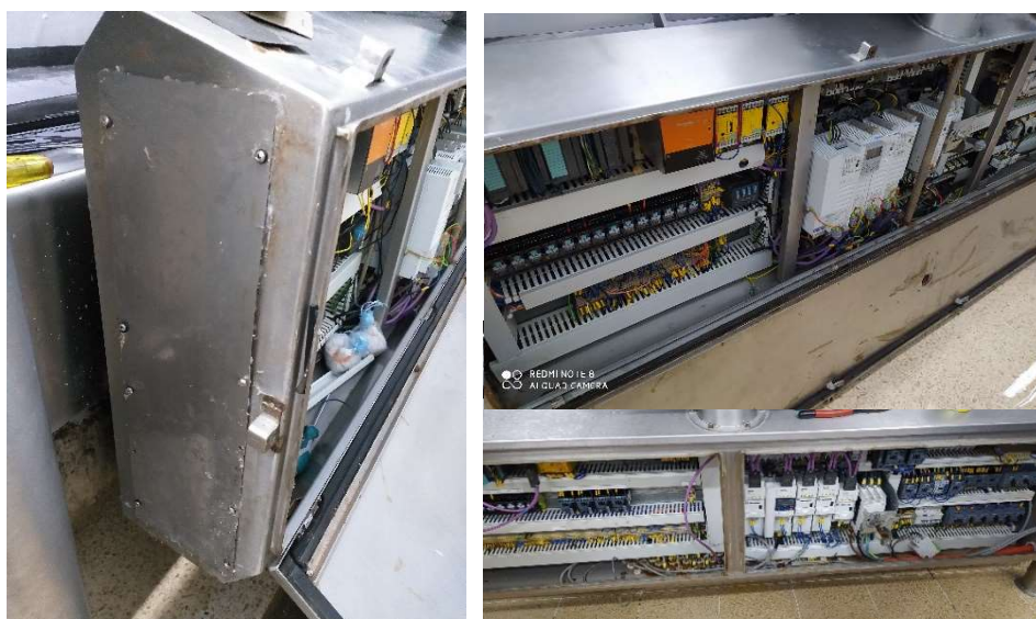
Figura 3.24 Orden del tablero principal del túnel Durán 1
