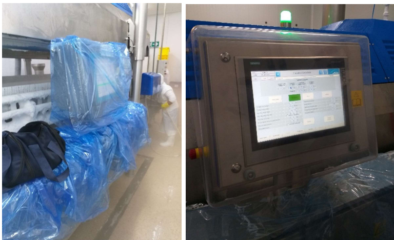
Figura 3.65 Cubrimiento plástico en tableros de control
