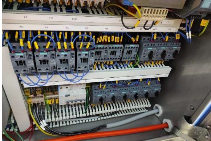
Figura 3.53 Estandarización de componentes eléctricos
