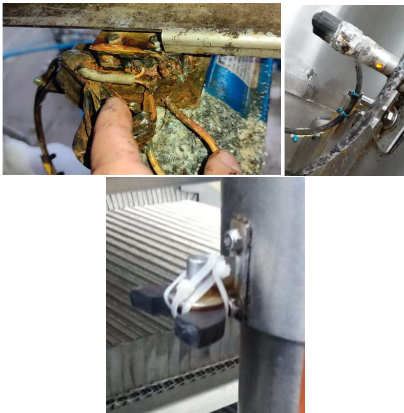
Figura 3.32 Sensores en mal estado
