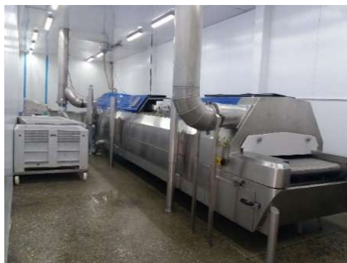
Figura 1.1 Túnel de Congelamiento de Criogenia SA
