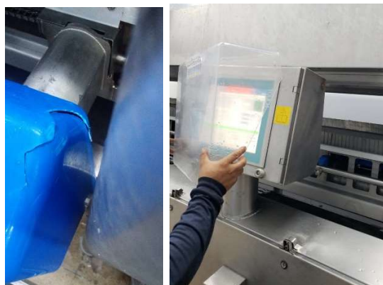
Figura 3.39 Protectores de acrílico en mal estado (Fuente: Planta de Proceso Empresa Durán)
