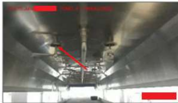
Ventilador apagados en el túnel # 2.
