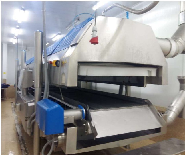
Figura 3.18 Acople de tubería de extracción de túnel Durán 1
