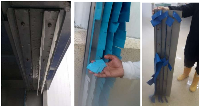
Figura 3.40 Cortinas de entrada y salida no funcionales
