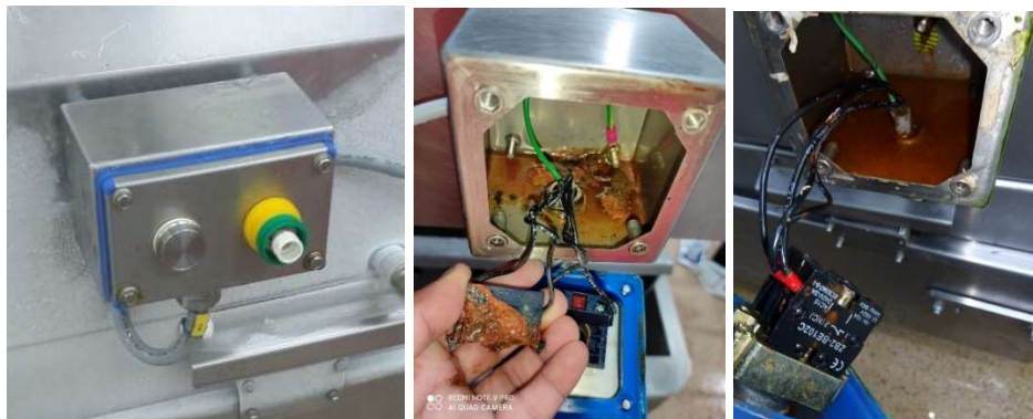
Figura 3.29 Paradas de emergencia en mal estado (Fuente: Planta de Proceso Empresa Durán)
