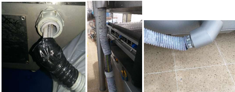
Figura 3.33 Fundas eléctricas en mal estado (Fuente: Planta de Proceso Empresa Durán)
