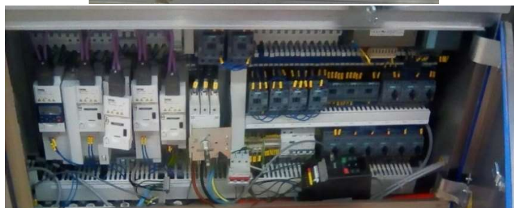
Figura 3.22 Hallazgo dentro de panel principal de Durán 2 (Fuente: Planta de Proceso Empresa Durán)
