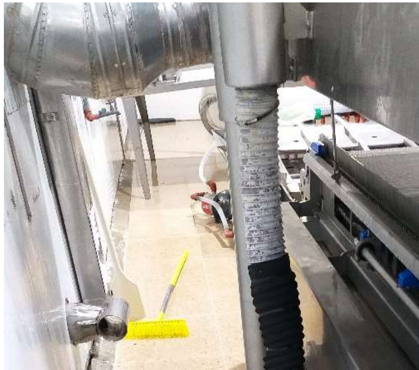
Figura 3.12 Hallazgo alrededor de túnel Durán 2
