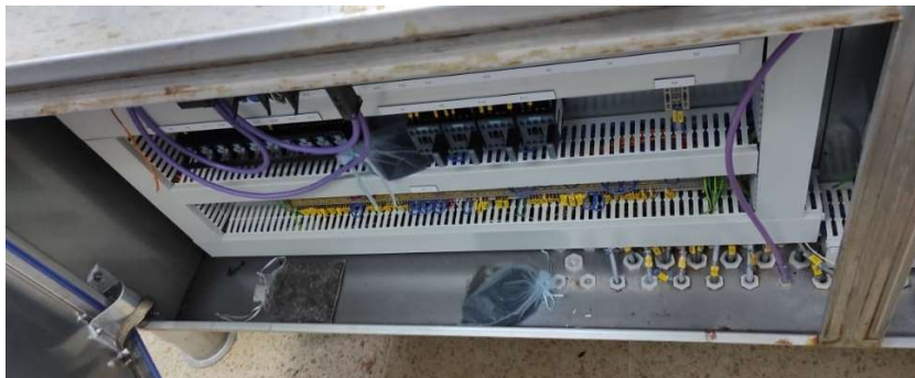
Figura 3.28 Recolección de excedente de cable de túnel Durán 3 (Fuente: Planta de Proceso Empresa Durán)
