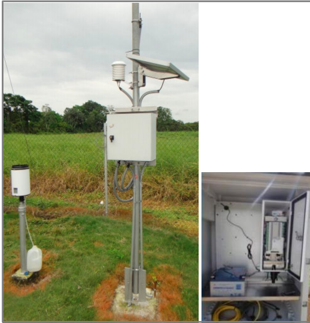
Figura 2.4 Estación meteorológica automática.
