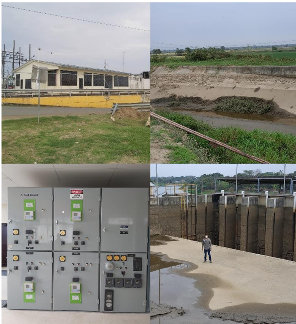
Figura 3.10: Sistema de bombeo de agua de la Junta de Riego-Daule
