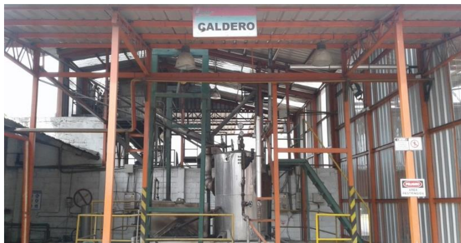
Figura 3.13: Caldero de cascarilla de arroz
