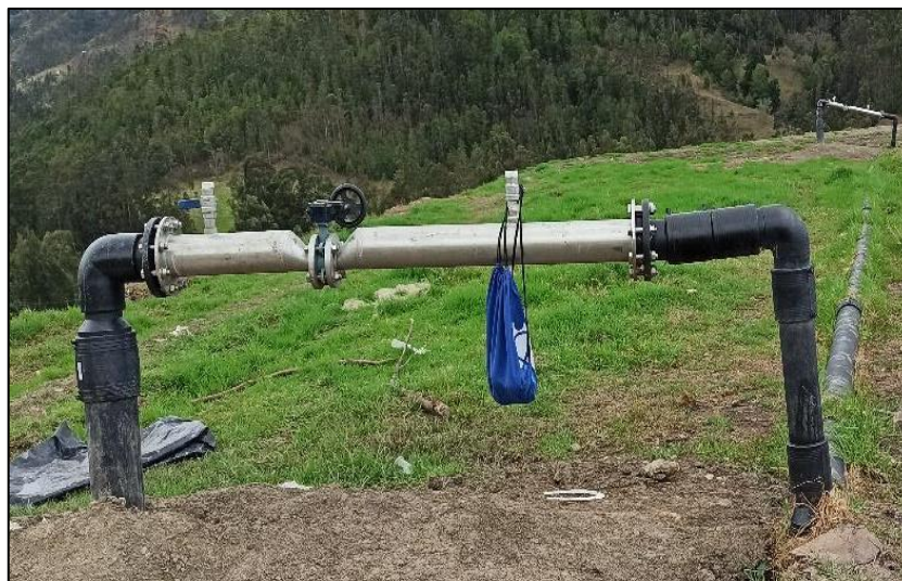
Figura 3.7 Cabezales de pozo
