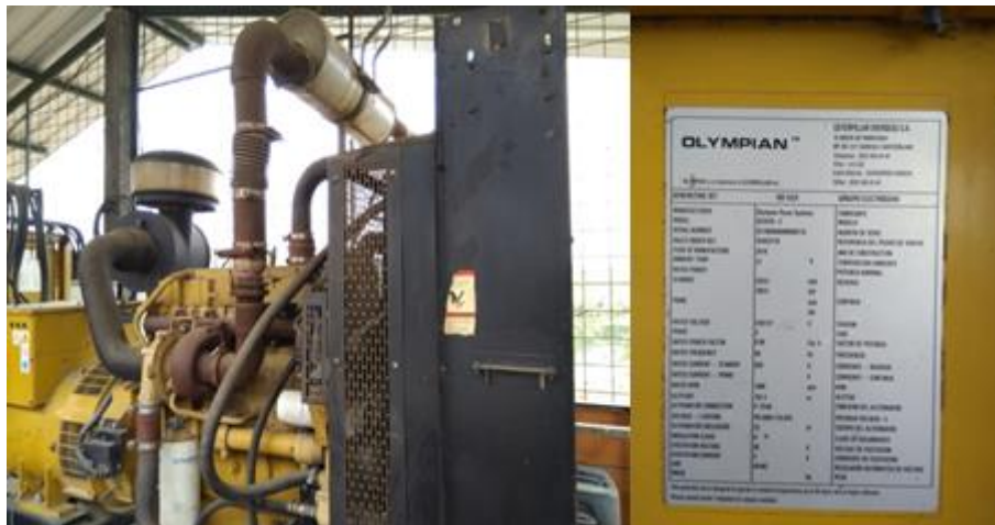
Figura 3.2: Grupo electrógeno utilizado en centro de acopio.
