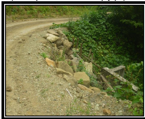
FIGURA 14: PUENTES EN MAL ESTADO (Parroquia La América-Jipijapa)
