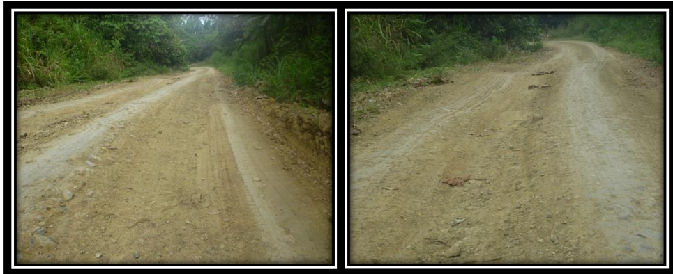
FIGURA 11: CAMINOS DE SEGUNDO ORDEN DETERIORADOS (Parroquia Julcuy-Jipijapa)
