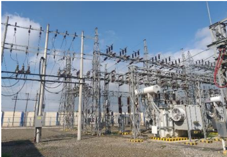
Figura N° 2.2 Subestación de distribución.
