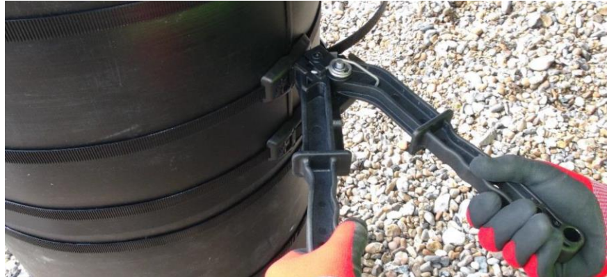
Figura 3.8 Zunchos de plástico para asegurar las chaquetas, siendo ajustados por las tijeras de presión. [Elaboración propia]
