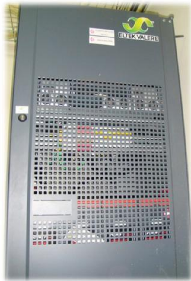
Figura 4.6 Regulador de Voltaje
