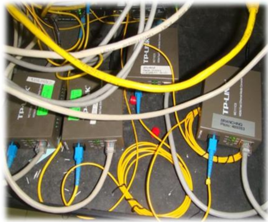
Figura A.5 Conexión de Fibra Óptica para empresas
