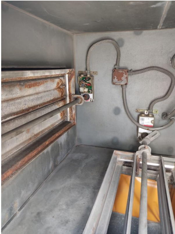
Figura 3. Dámper de renovación de aire en UMA cerrado
