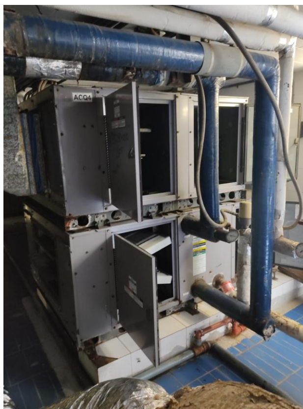
Figura 2: Manejadora de Quirófano.
