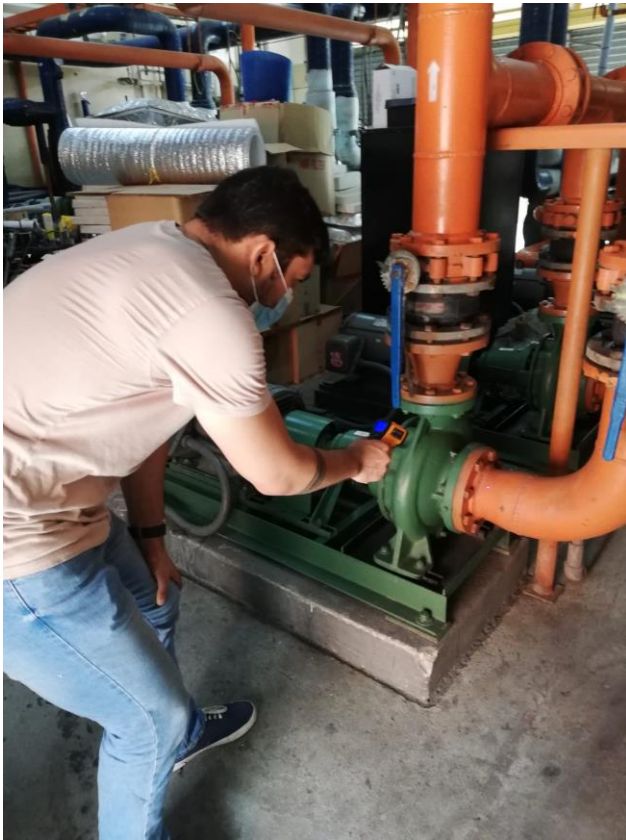
Figura 9 Toma de temperatura de entrada a la bomba de condensado.
