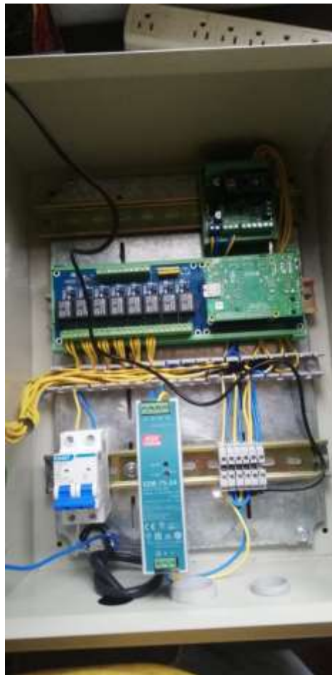
Foto 4 Cableado de los equipos que conforman el tablero.
