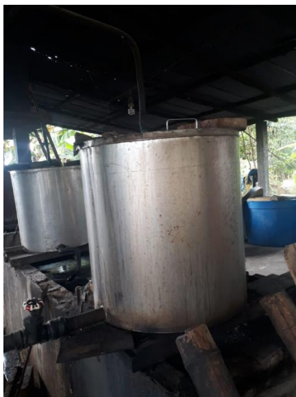
Figura. 1.7.a Tanques de alimentación del mosto a los alambiques (cortesía del emprendedor).
