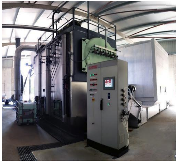
Figura 1-1 Caldera de vapor automatizada (Chang, 2011)
