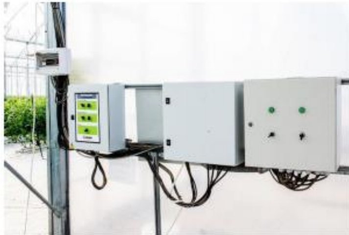
Figura 2-2. Tablero de Control en Invernadero [25].
