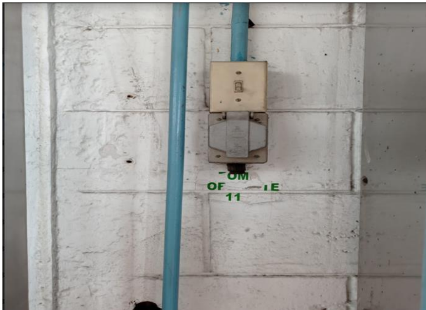
Figura 4.6 Interruptor tipo residencial en área de Patio de almacenamiento de combustibles Fuente: Empresa
