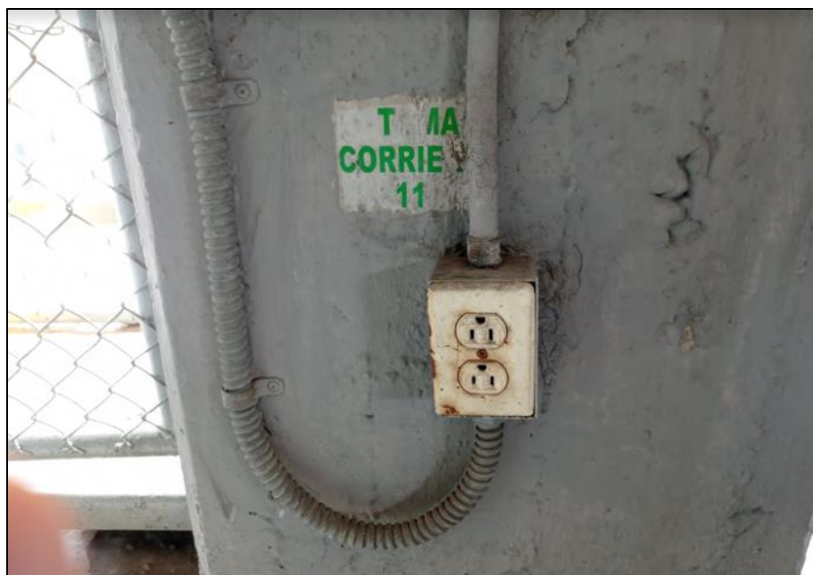
Figura 4.4 Tomacorriente 1 tipo residencial en área de patio de almacenamiento de combustibles Fuente: Empresa
