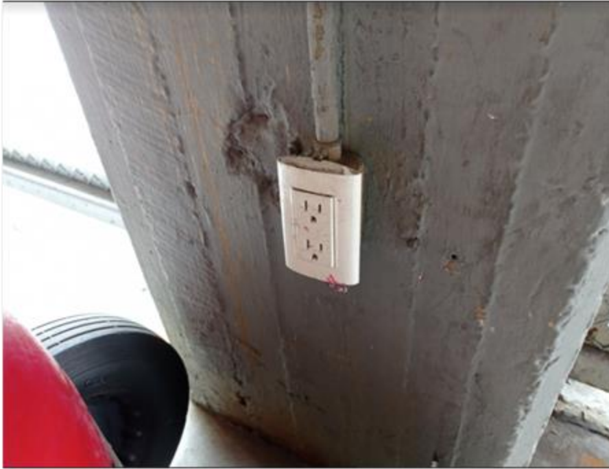
Figura 4.5 Tomacorriente 2 tipo residencial en área de Patio de almacenamiento de combustibles Fuente: Empresa
