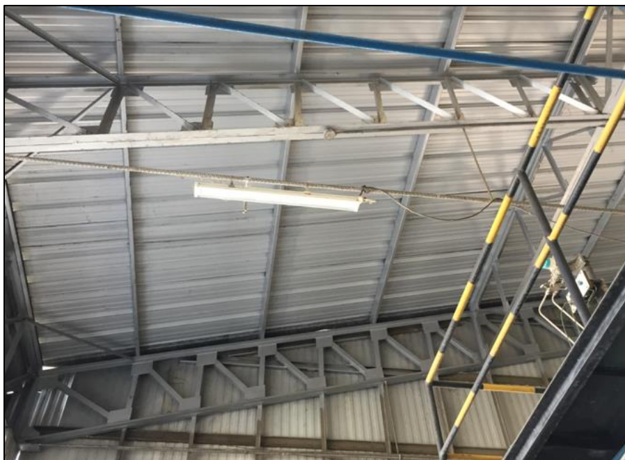
Figura 4.3 Acometida eléctrica colgada de luminaria en techo sector de calderas Fuente: Empresa
