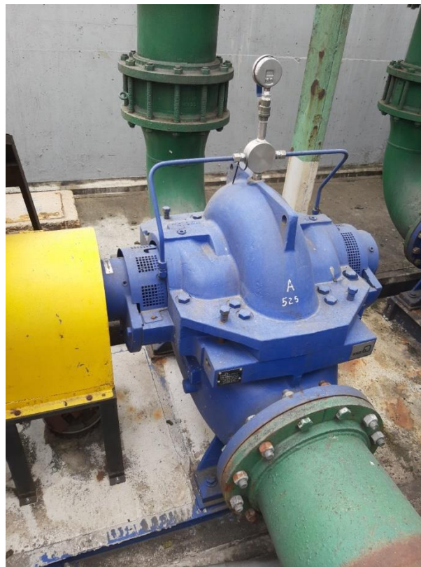
Figura 2.3 Nueva bomba con cabezal de 30m y caudal de 720m 3 /h
