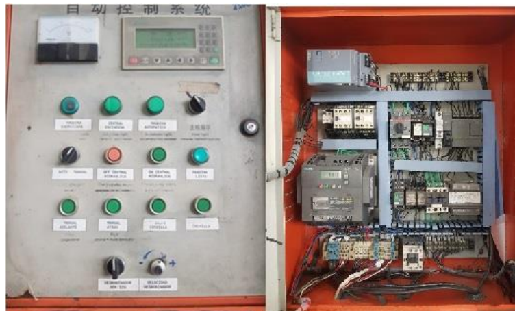
Imagen 57 Tablero de control actual [Autoría propia]
