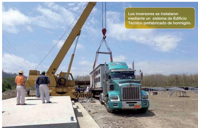
Figura 2.4 E.T. prefabricado de hormigón donde se instalaron los inversores [41].
