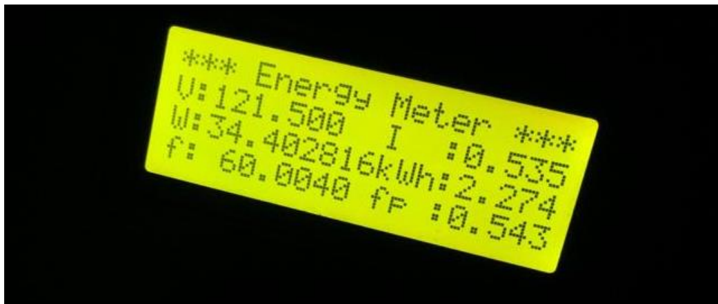
Figura 4.9 Resultados de la medición de energía en el armario semafórico
