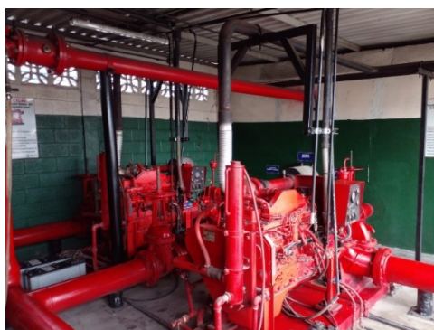
Figura 1.6 Sistema contra incendios de Fertisa
