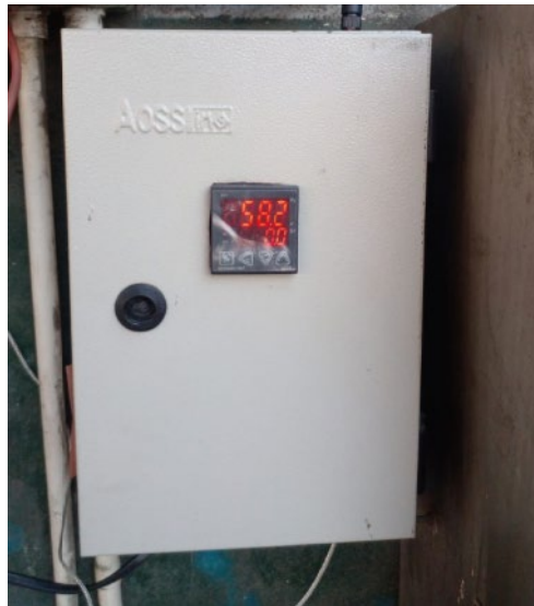
Figura 3.14 Temperatura de la Bodega #34
