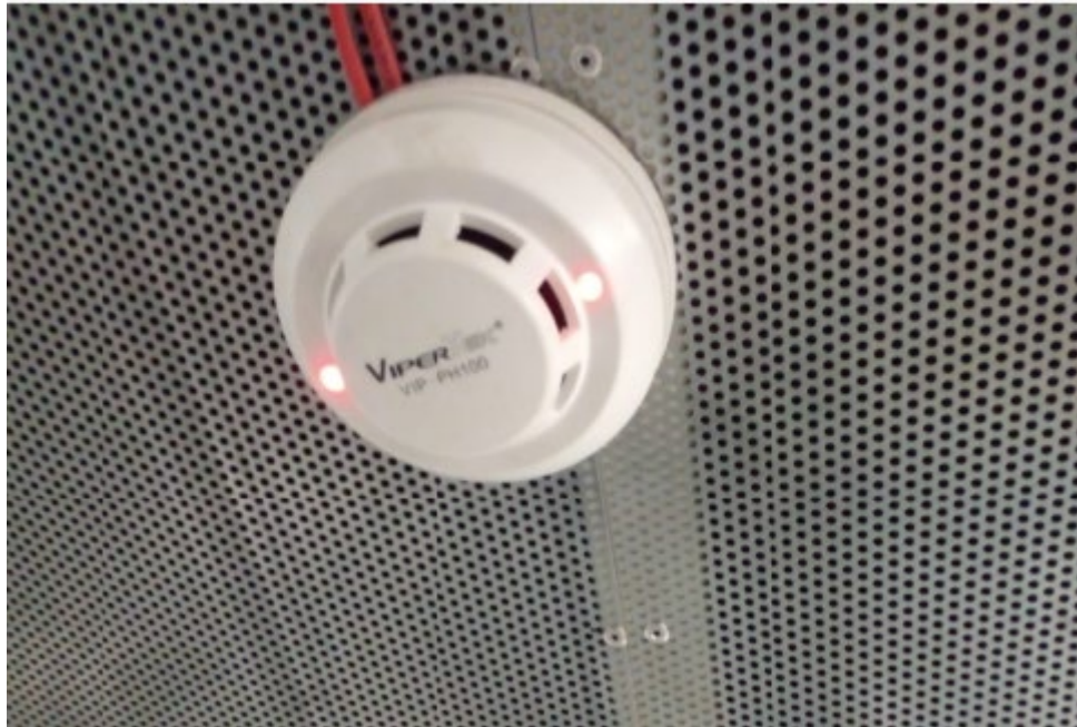
Figura 3.17 Detector de humo activado en grúa Gottwald #2
