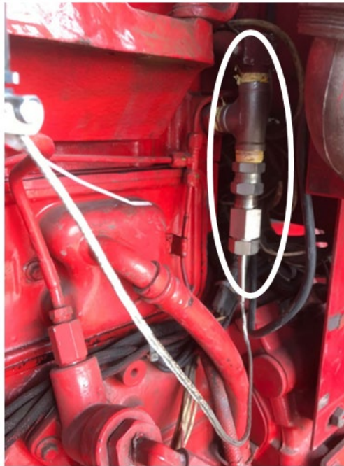
Figura 2.12 RTD instalado en bomba del SCI
