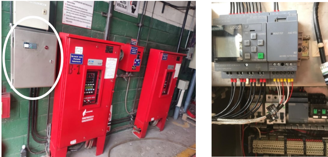
Figura 2.13 PLC LOGO instalado en tablero eléctrico del SCI
