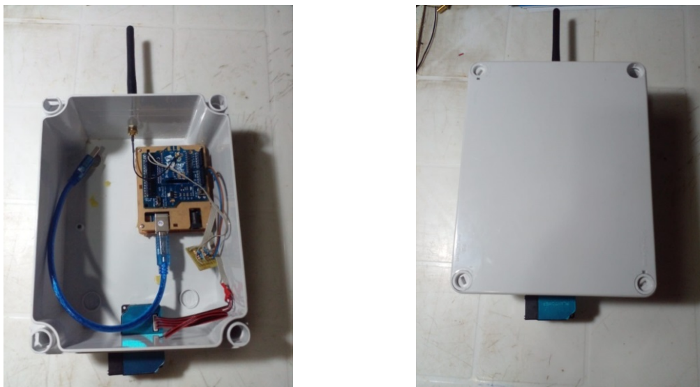
Figura 2.20 Instalación de módulo XBee S2C en zona Este de Fertisa
