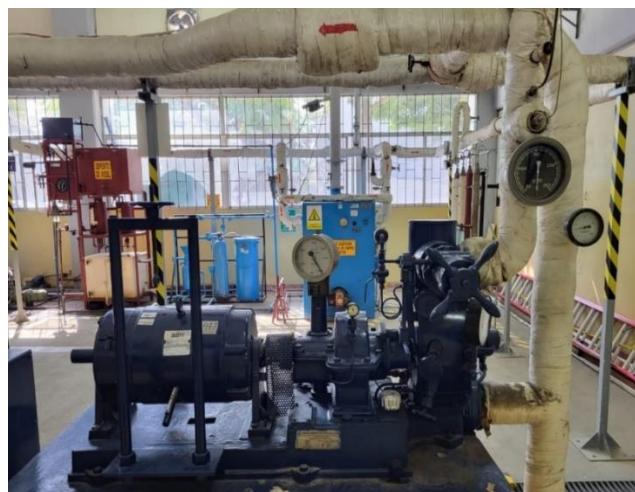
Figura 1.6. Vista de la Turbina de Vapor y Generador.
