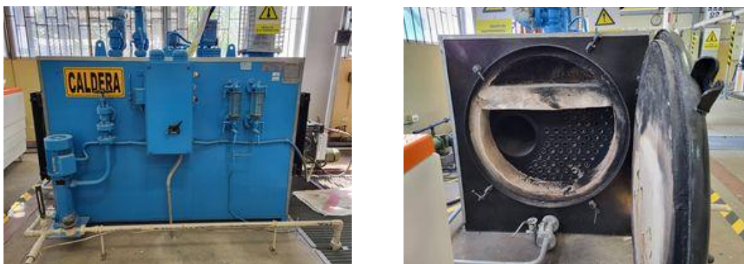
Figura 1.4. Vista de la Caldera, Lab- Termofluidos-ESPOL.
