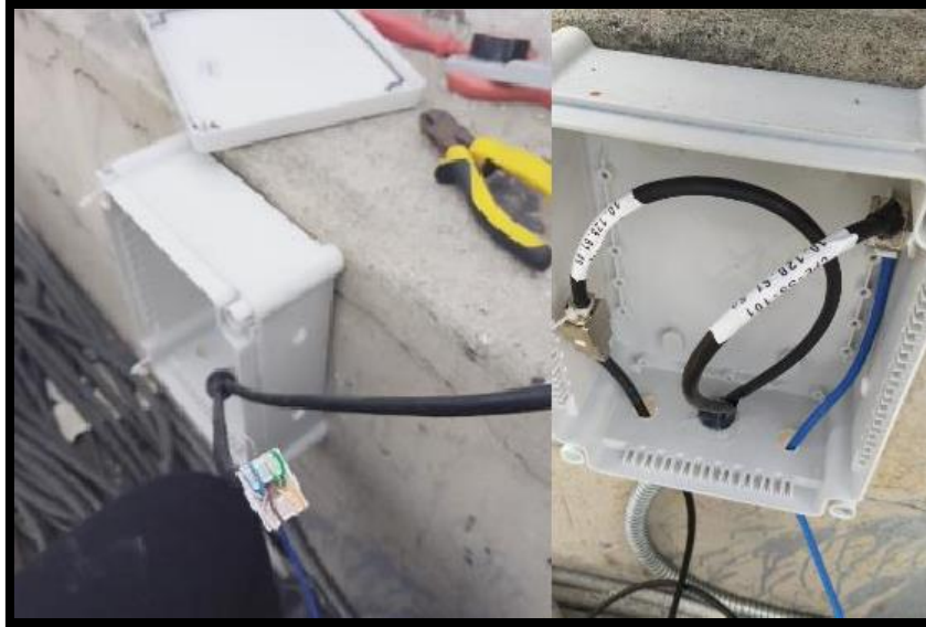
Ilustración 17 Ubicación de la caja de conexiones
