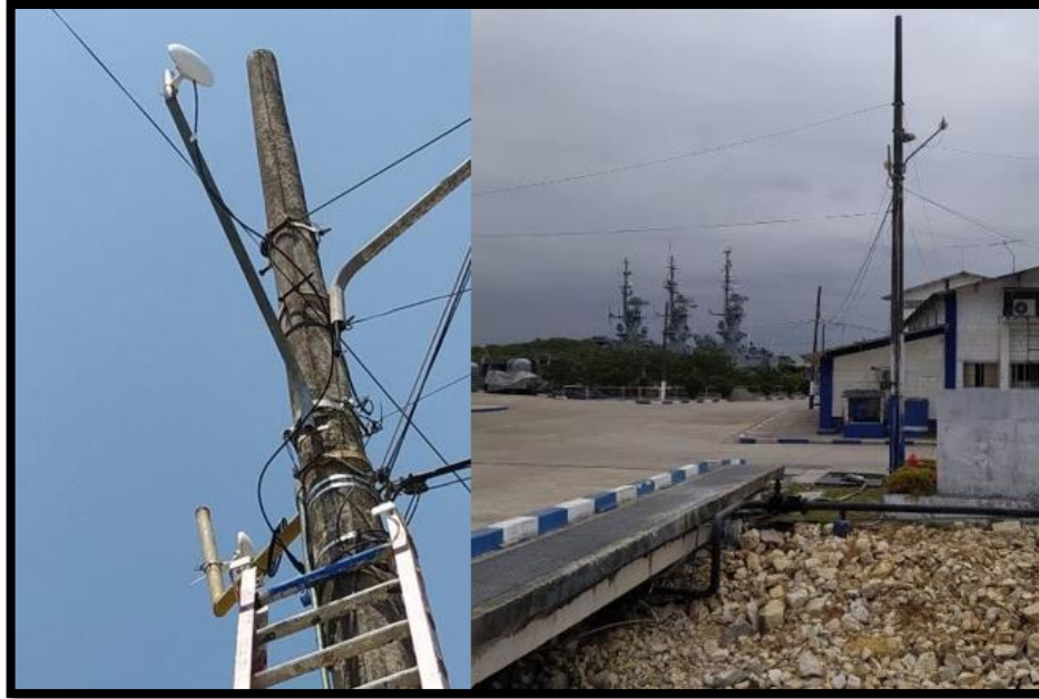
Ilustración 15 Ubicación de equipos receptores
