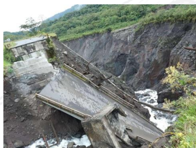
Fotografía 3. Colapso total del puente sobre el río Montana. Fuente: SNGRE C22 UMEVA Napo Orellana
