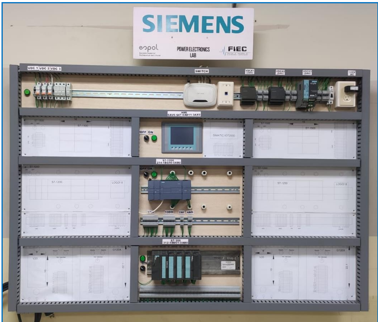
Figura 62 Tablero de entrenamiento de la marca Siemens ensamblado por el autor de este proyecto de titulación.
