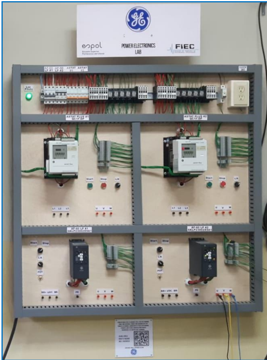
Figura 14 Tablero de entrenamiento de la marca General Electric.
