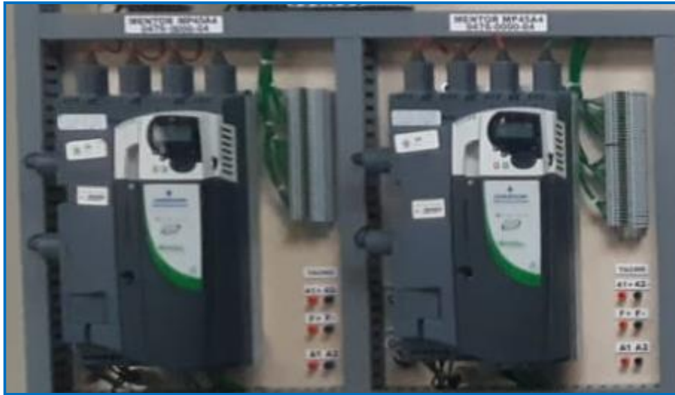
Figura 5 Dos drives DC Mentor MP del tablero eléctrico de la marca Emerson disponible del Laboratorio de Electrónica de Potencia.
