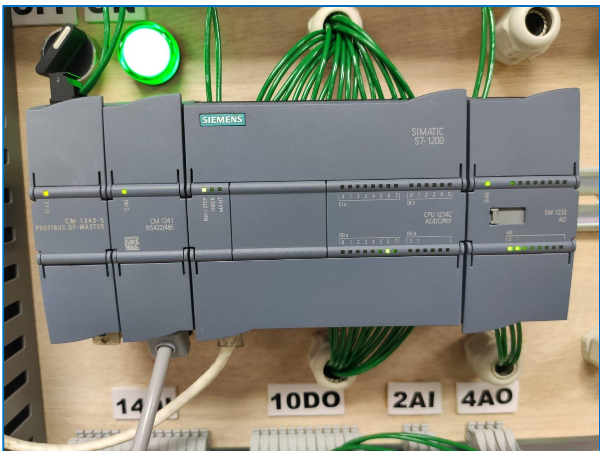
Figura 1 PLC Siemens S7-1200 con 2 módulos de comunicación y uno de señales.
