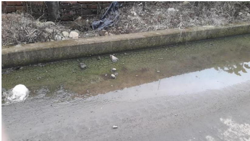
Ilustración 14. Problemas encontrados: Hundimientos. Fuente: Elaboración propia
