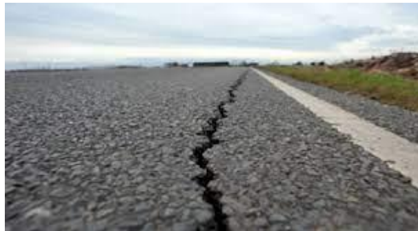
Ilustración 6. Grietas de borde. Fuente: Miranda, 2010
