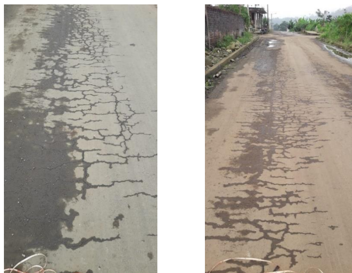
Ilustración 15. Problemas encontrados: Agrietamientos. Fuente: Elaboración propia
