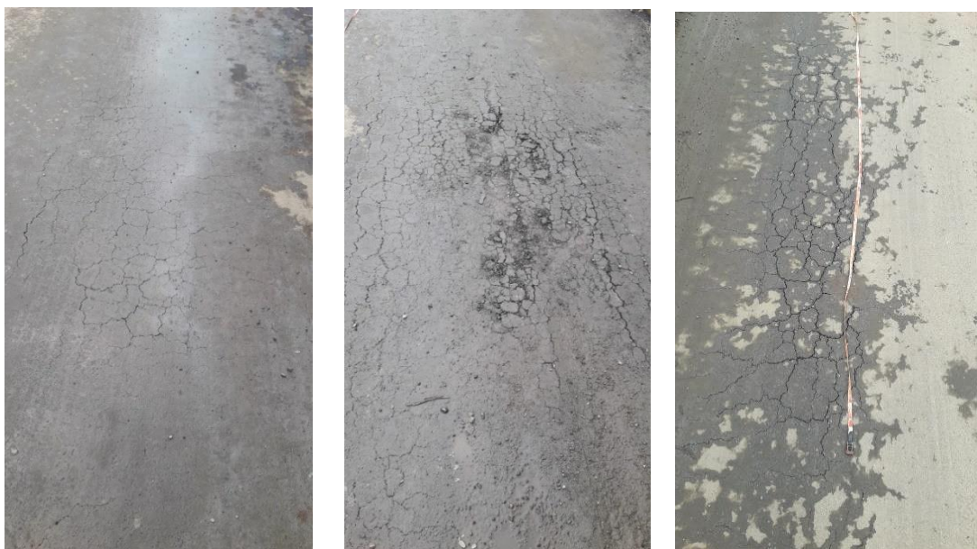
Ilustración 13. Problemas encontrados: Piel de cocodrilo. Fuente: Elaboración Propia
