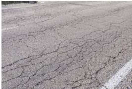
Ilustración 5. Fisuras por fatigamiento. Fuente: Miranda, 2010
