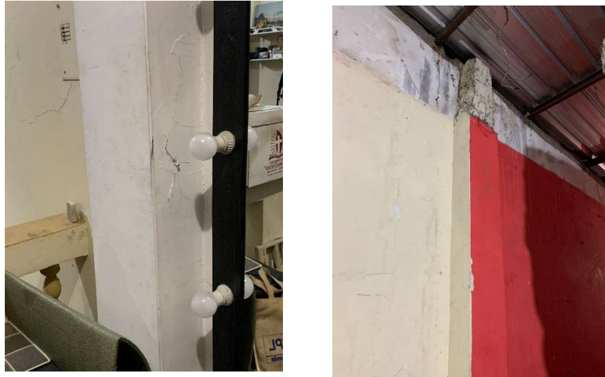
Figura 1.19 Fisuras en columna al ingreso de planta alta.
