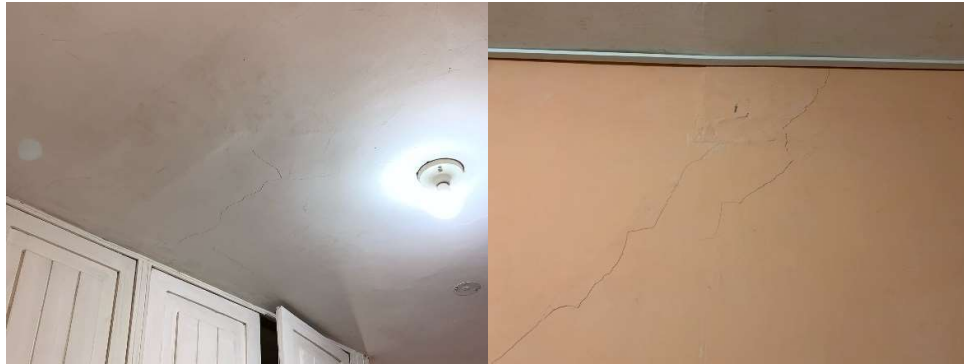
Figura 1.14 Habitación principal de planta baja con fisuras en losa y paredes.
