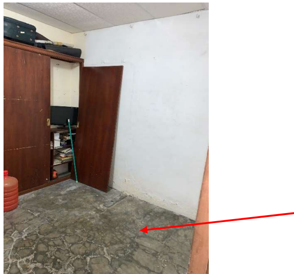
Figura 1.20 Suelo agrietado lo que permite el flujo del agua al interior de la planta baja.
