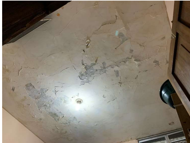
Figura 1.10 Alta presencia de humedad en losa de habitación #2.
