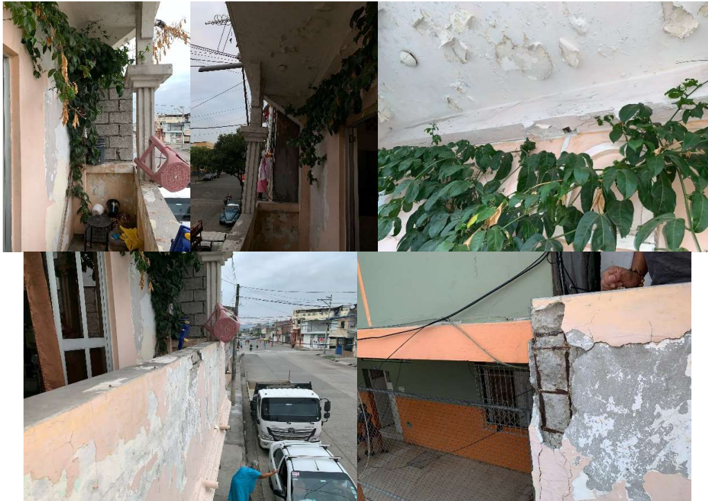
Figura 1.18 Acero expuesto en balcón junto con problemas de humedad en las paredes.
