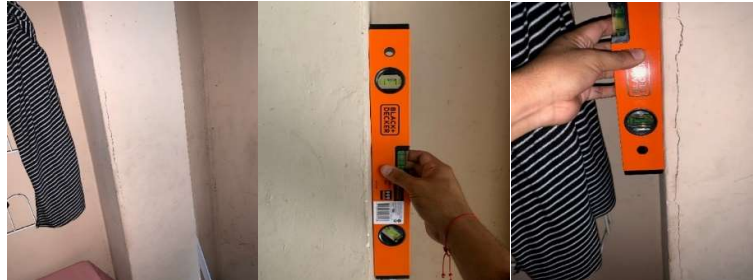
Figura 1.7 Fisuras en columna A2
