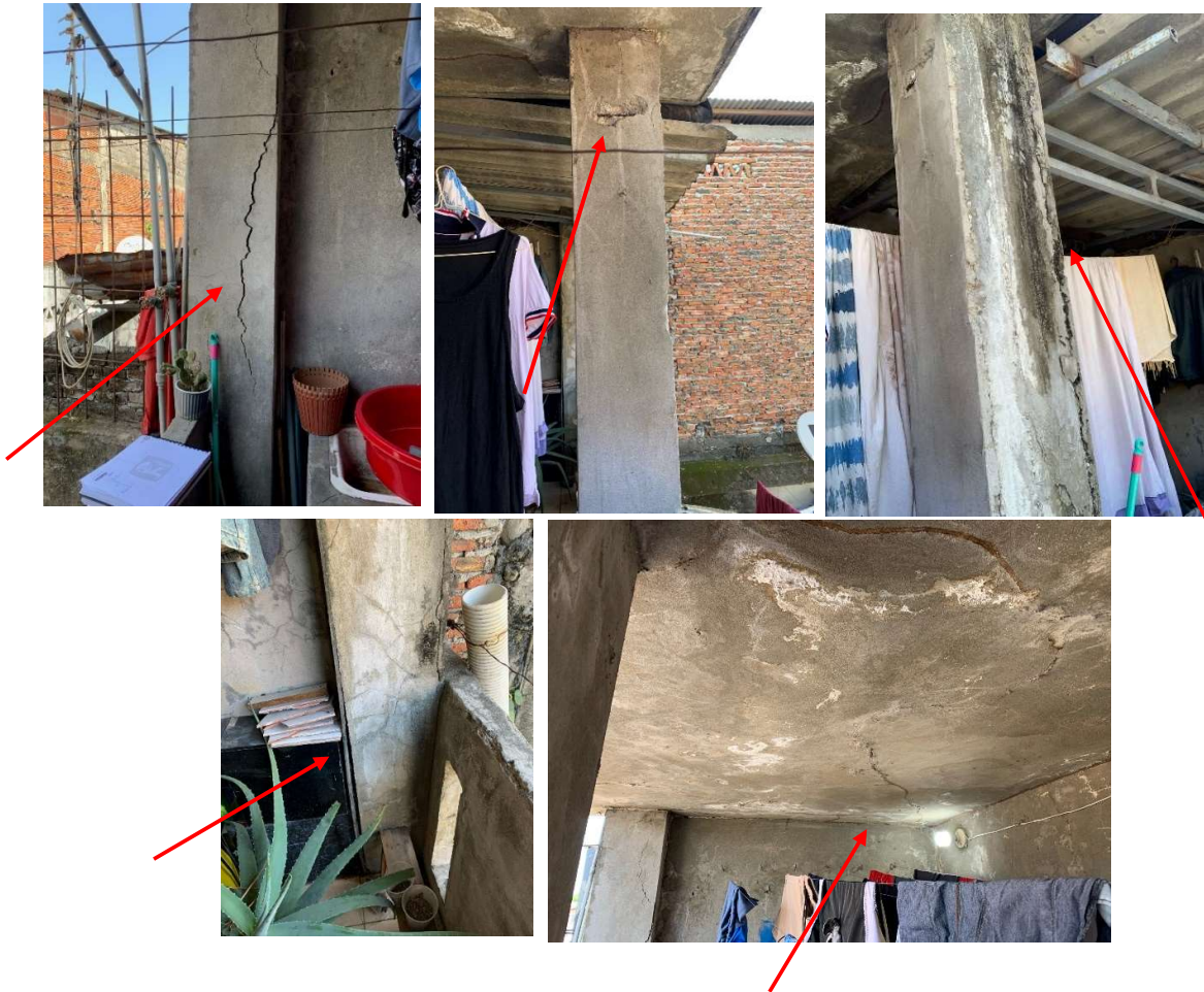
Figura 1.21 Gran cantidad de fisuras en el balcón
