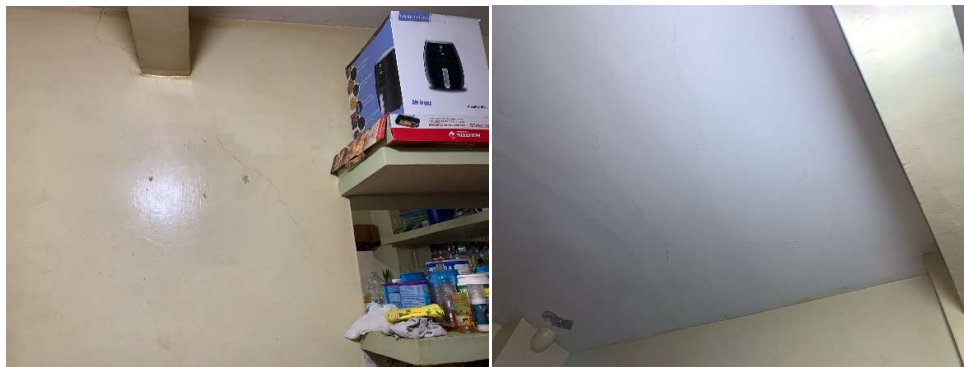
Figura 1.15 Grietas en pared de cocina con el mismo sentido que las grietas del cuarto anexo, además de presencia de fisuras en su losa.
