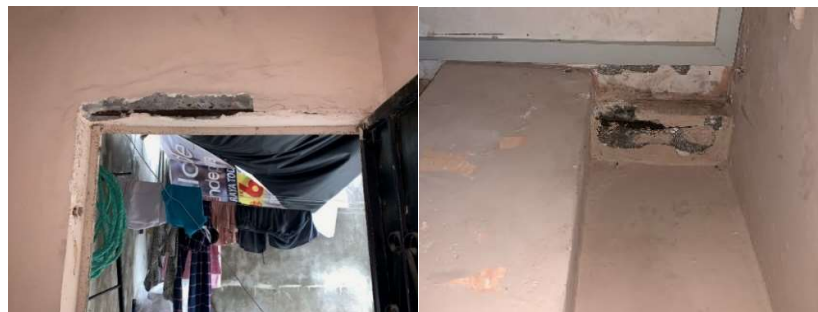
Figura 1.8 Desprendimiento del hormigón en borde de puerta y viga.
