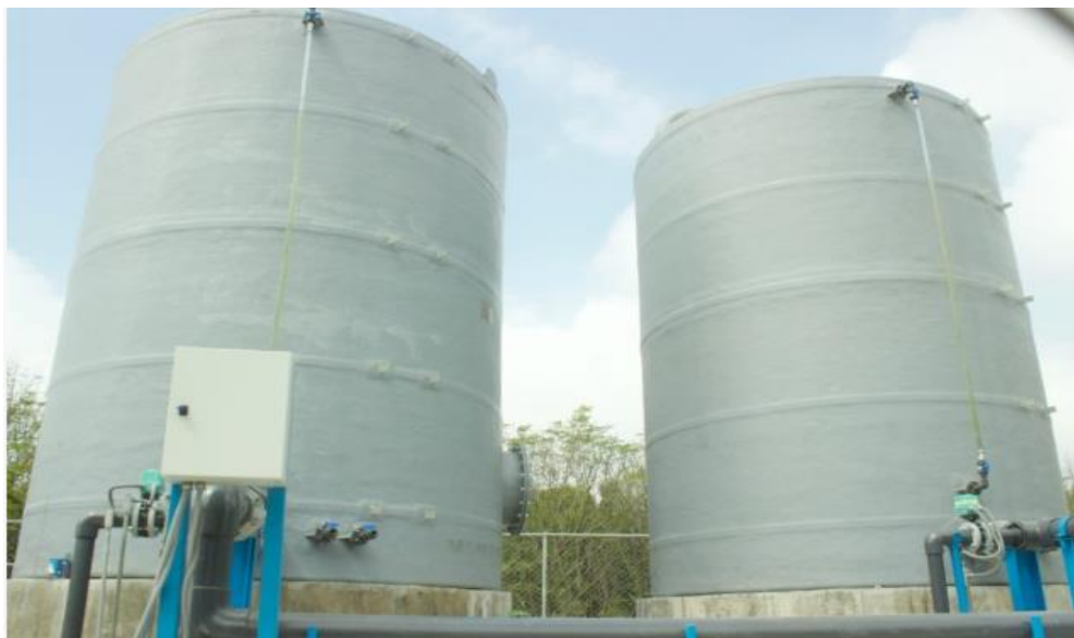
Figura 2.8 Tanques de almacenamiento. [Industrial Plastirrey, 2022]
