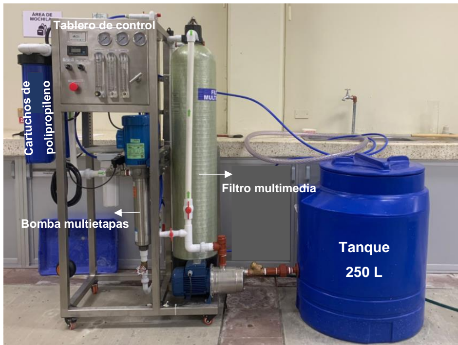
Figura 2.1 Planta de tratamiento de Ósmosis inversa, perteneciente a la Facultad de Ciencias de la Tierra de ESPOL, parte frontal
