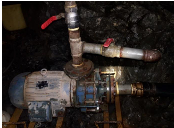
Fotografía 1.1 Bomba centrífuga instalada en interior mina de OROSOL UNO
