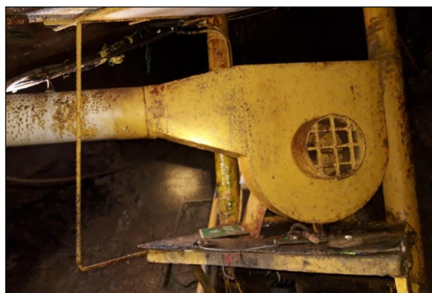
Fotografía 1.2 Ventilador axial instalado en interior mina de OROSOL UNO
