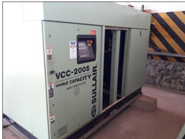
Fotografía 1.4 Compresor empleado en la mina de OROSOL UNO
