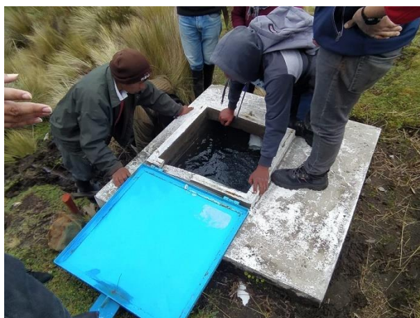
Figura 2.5 Tanque de captación principal actual [Barahona & Rivas, 2022]
