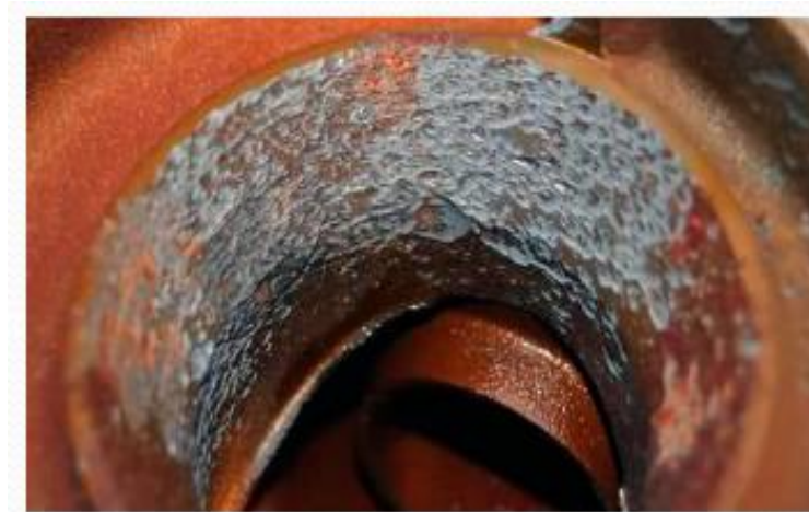
Figura 7. Parte de la bomba afectada por cavitación
