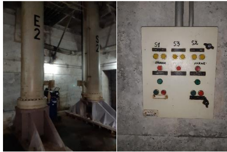
Figura 5.- Pistones hidráulicos y tablero de mando local.
