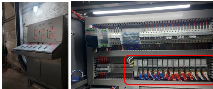
Figura 11.- Tablero T3 consola de operación (nivel 29).
