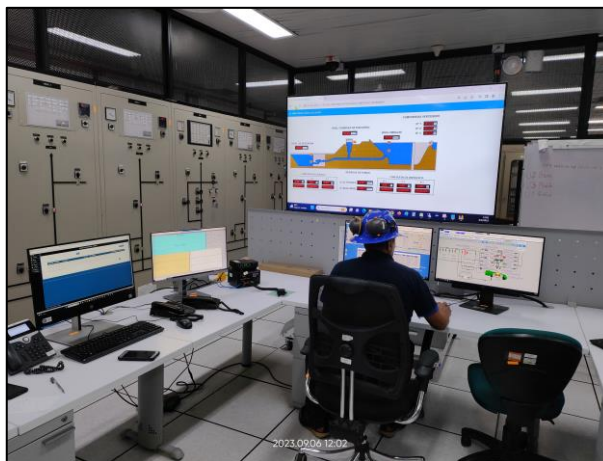
Figura 44.- Uso de la aplicación Nodo-Red en Sala de Control de la CHMLW.
