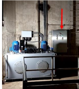
Figura 10.- Tablero T2 de fuerza y grupo oleo hidráulico (nivel 43).
