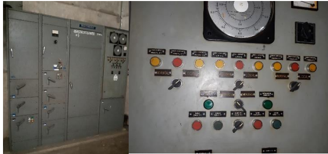
Figura 3.- Tablero de control, Centro de Control de Motores (CCM) y distribución.
