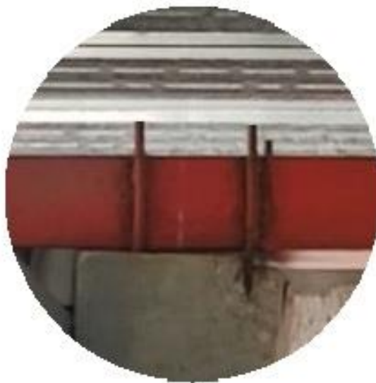
Figura 3.25 Zoom columna principal A1 del 2do. piso.
