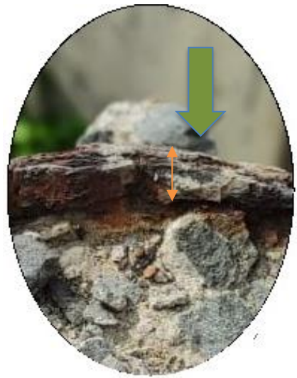
Figura 3.21 Zoom tubería de acero con sección de espesor expandido a 4-5 mm por corrosión. Fuente: Eva Chacón y Brayan Pinto
