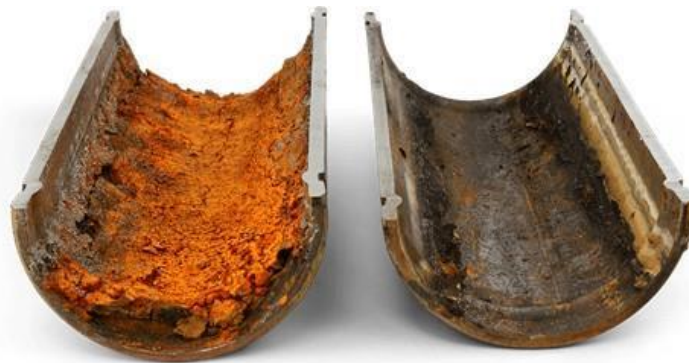
Figura 3.17 Corrosión de los oleoductos.
