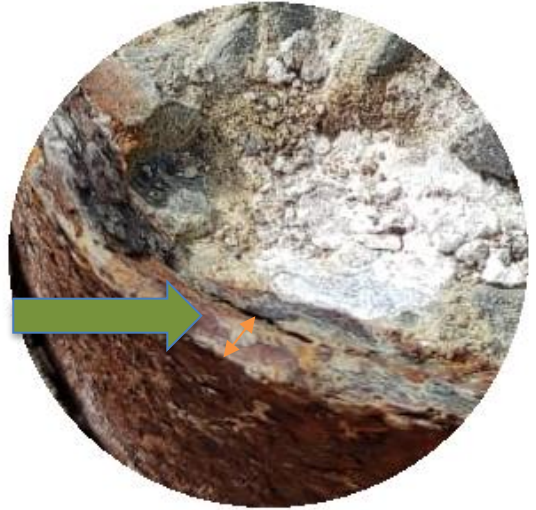
Figura 3.18 Zoom tubería de acero con sección de espesor 3 mm. Fuente: Eva Chacón y Brayan Pinto
