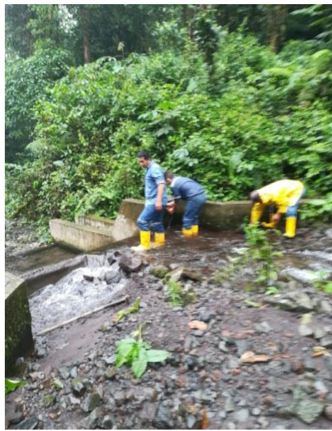
Figura 1.3 Colapso de la rejilla de ingreso de la captación [GAD Gonzalo Pizarro,2022]
