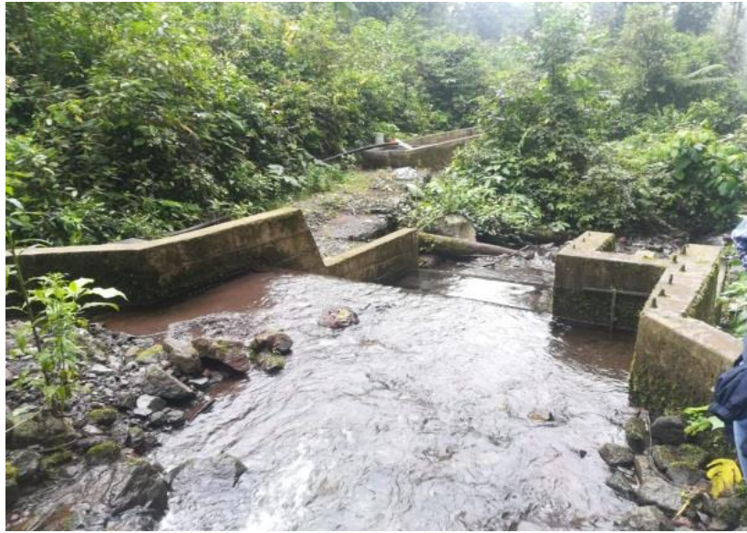
Figura 1.2 Estructura de captación actual [GAD Gonzalo Pizarro,2022]
