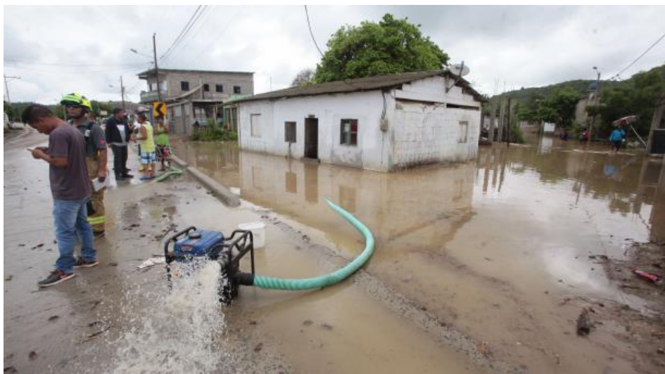
Ilustración 3-1 El Cuerpo de Bomberos realizó trabajos para drenar el agua. Foto: Enrique Pesantes / EL COMERCIO año 2020
