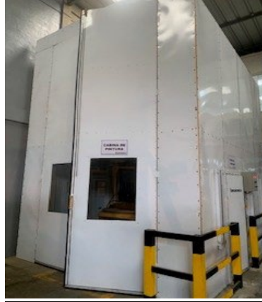
Figura 2.20 Cabina de Pintura
