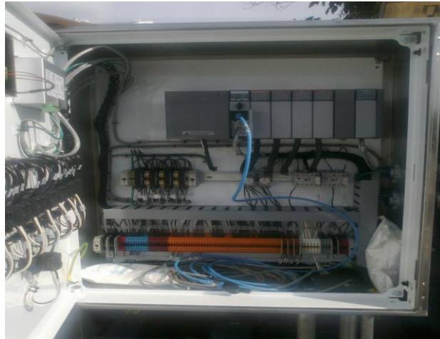
Figura 1.14: Cable Ethernet CAT6 conectado al PLC
