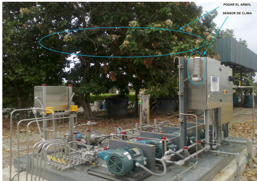
Figura 1.10: Sistema Meefogging instalado en su totalidad
