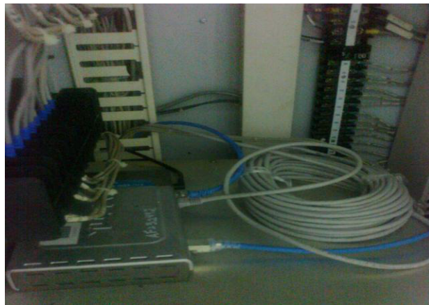
Figura 1.15: Cable Ethernet CAT6 conectado al switch Ethernet
