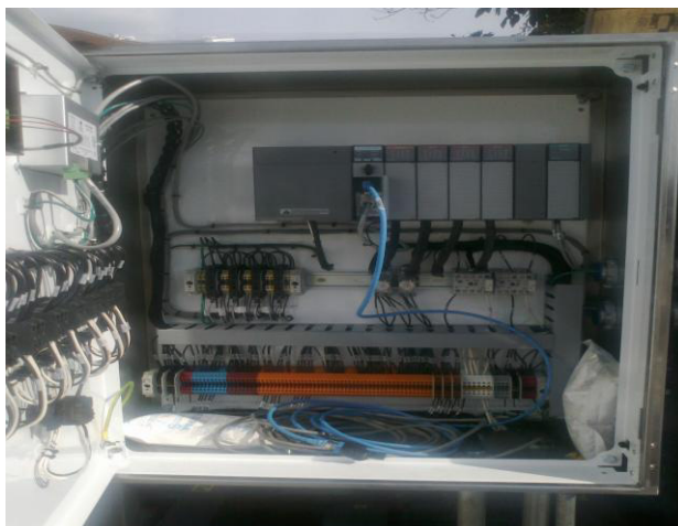
Figura 1.14: Cable Ethernet CAT6 conectado al PLC
