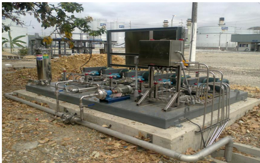
Figura 1.4: Skid del Sistema Meefogging instalado
