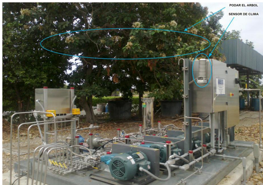
Figura 1.10: Sistema Meefogging instalado en su totalidad
