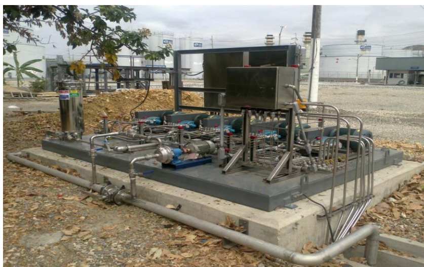
Figura 1.4: Skid del Sistema Meefogging instalado
