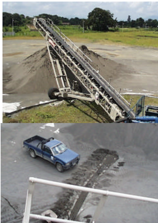
Figura 3.31 Transportador Stacker (arriba) Losa con canal (abajo)
