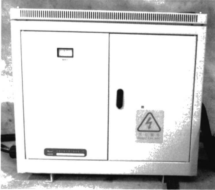
Figura 17. Transformador que arroja un voltaje en su bobinado secundario de 380 V. Para así alimentar a tablero principal y a su vez a los motores del sistema.
