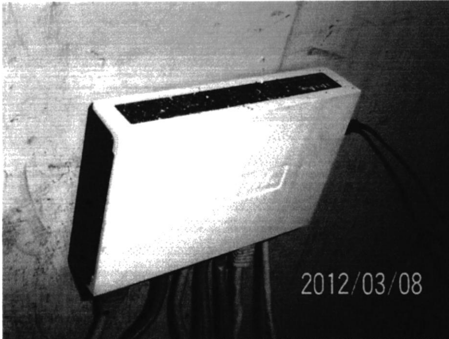
FIG. 30: Switch TP-Link correctamente instalado
