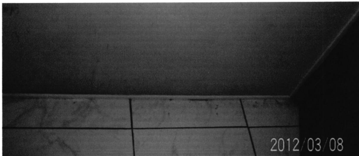
FIG. 28: Regleta correctamente instalada
