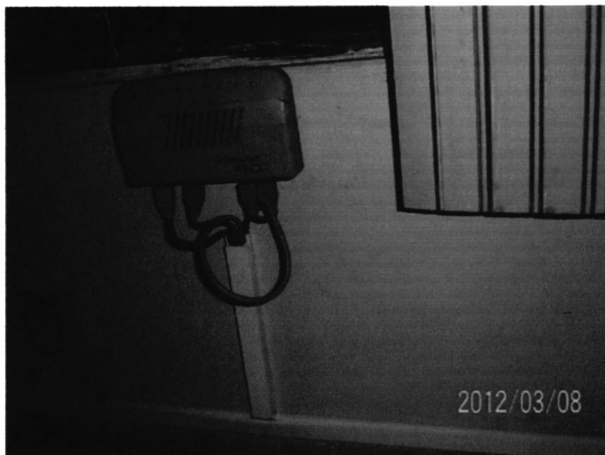
FIG. 29: Switch Cnet correctamente instalado
